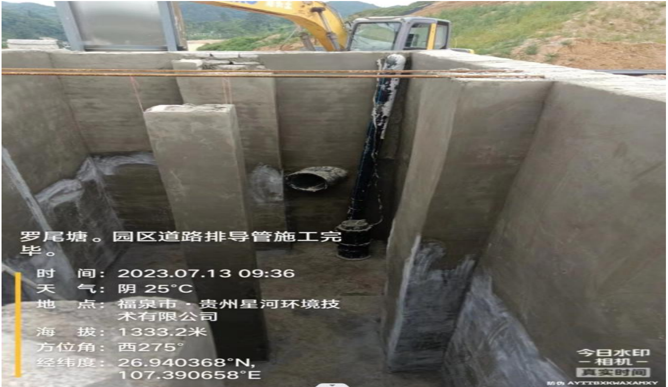
收集池和抽水泵
