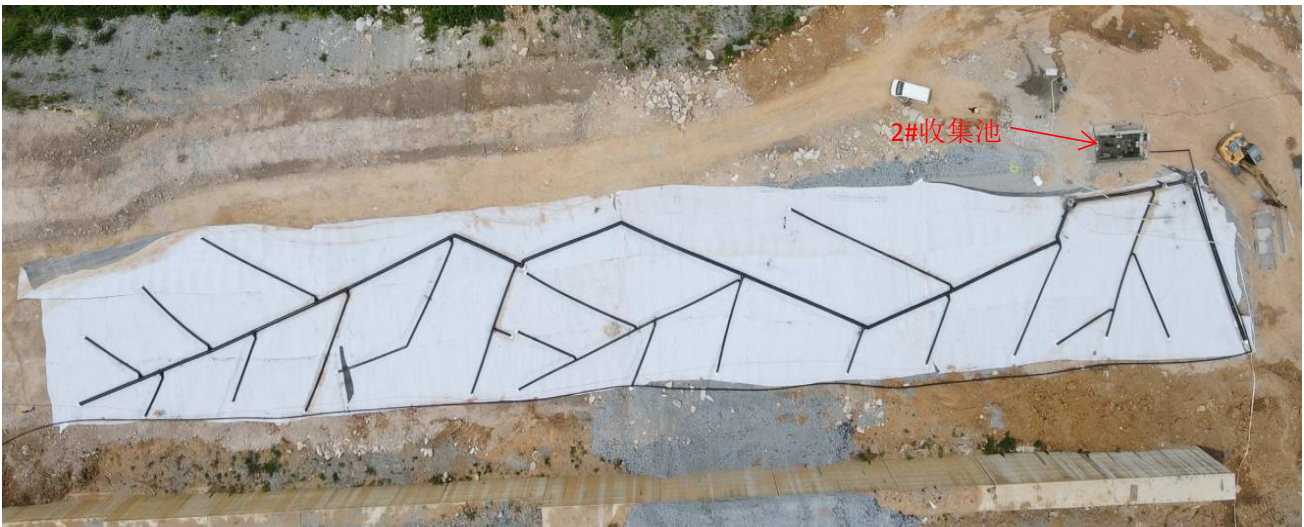
K0+600 处 2#收集池及导排管
