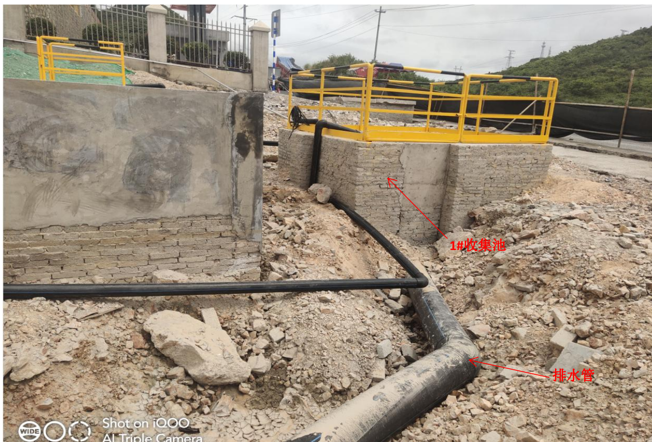
收集池和抽排水管道
