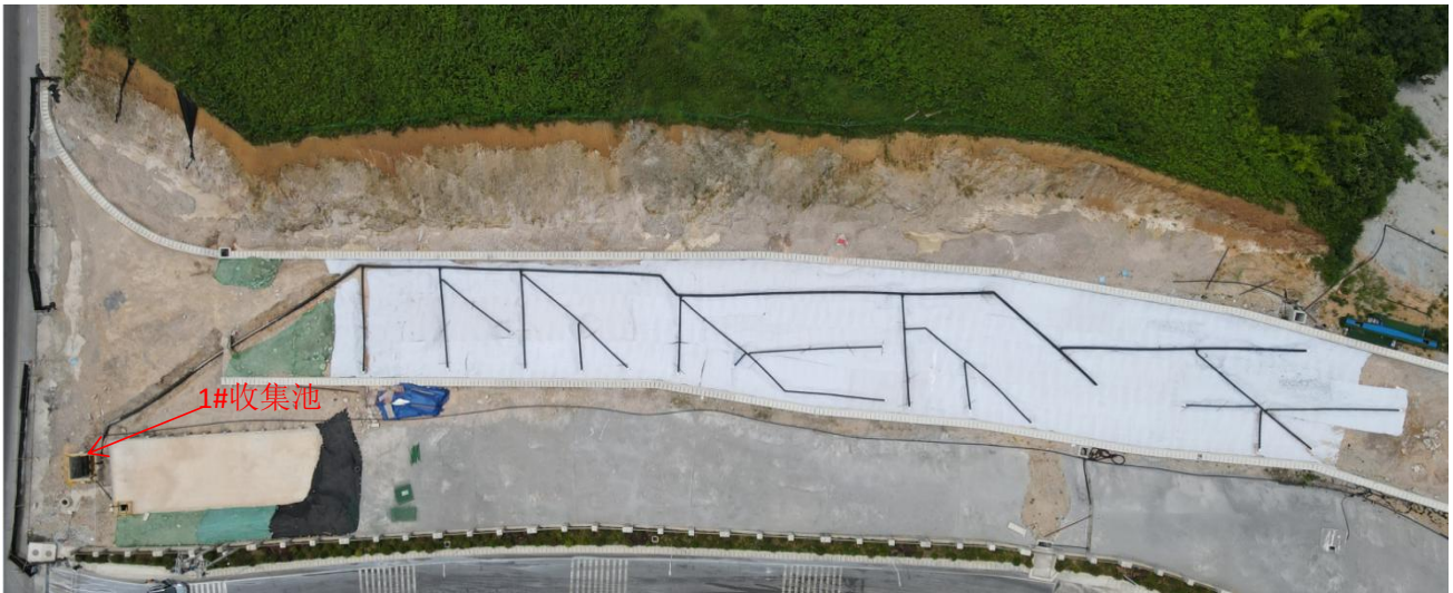
K0+000 处 1#收集池及导排管
