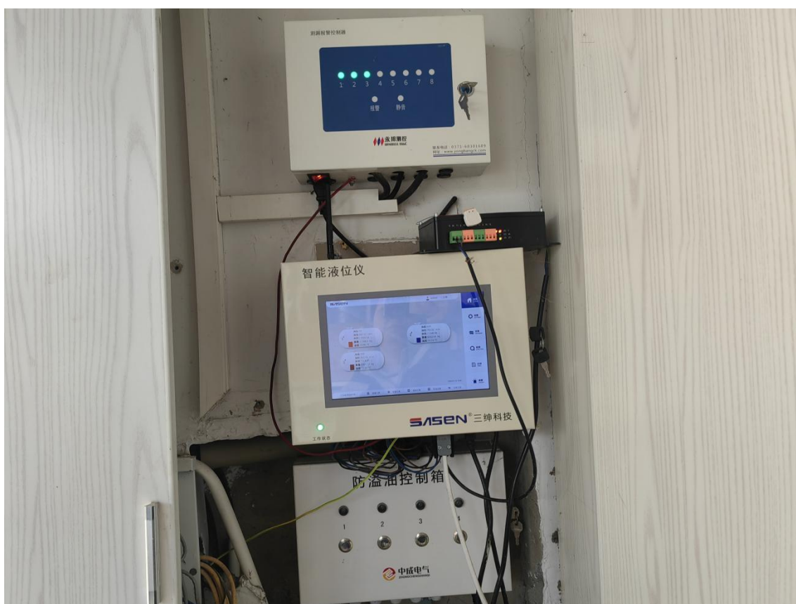
液位仪、渗漏检测仪
